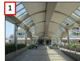
連絡通路の雨漏りと天井落下
