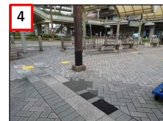
駅前広場タイル割れ
