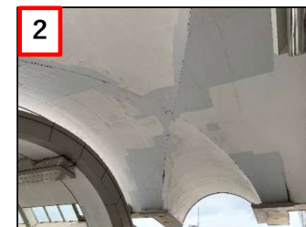
接続部の雨漏りと天井落下
