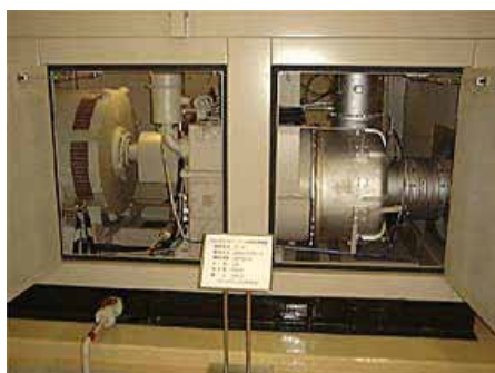
図 1-20 非常用自家発電設備
