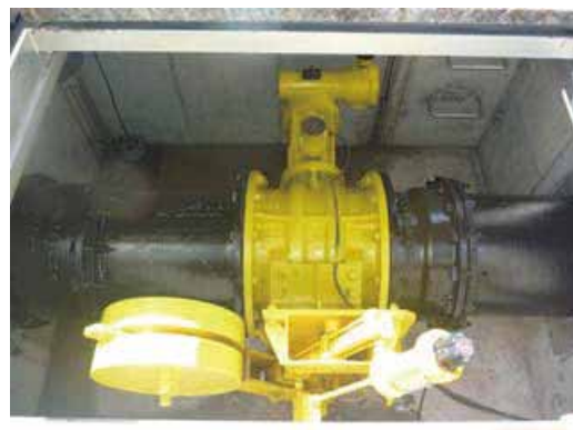
図 1-18 緊急遮断弁（千里丘送水所）
