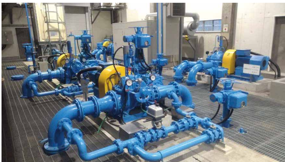
図 1-44 高効率ポンプ (中央送水所)
