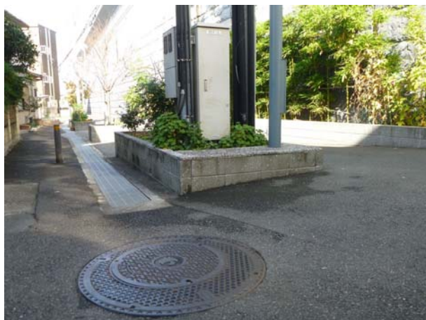
図 2-30 平成 30（2018）年 9 月の台風 21 号で被害を受けた 鳥飼和道二丁目のマンホールポンプ
