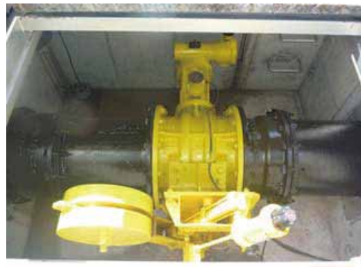
図 1-18 緊急遮断弁（千里丘送水所）
