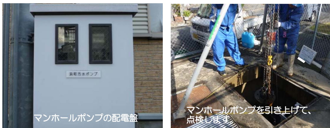
図 2-8 マンホールポンプの点検時の様子
