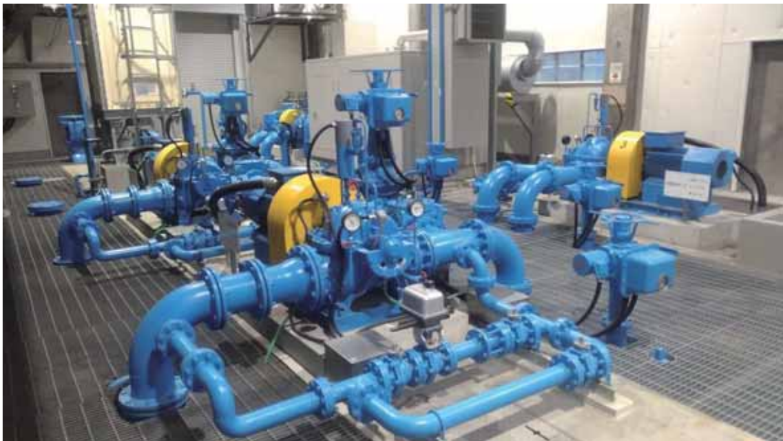
図 1-45 高効率ポンプ（中央送水所）
