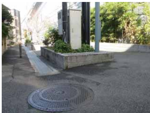
図 2-42 平成 30（2018）年 9 月の台風 21 号で被害を受けた 鳥飼和道二丁目のマンホールポンプ
