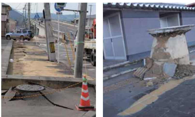
図 2-26 液状化被害の事例
