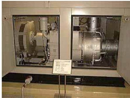
図 1-19 非常用自家発電設備
