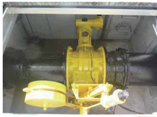
図 1-17 緊急遮断弁（千里丘送水所）
