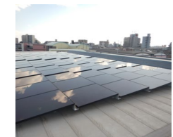
太陽光パネル
