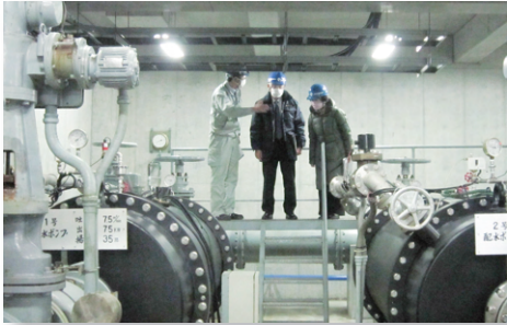
▷千里丘送水所（ポンプ室）での施設監査
