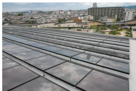
▼コミュニティプラザに設置の太陽光発電設備
