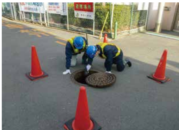
△市職員による緊急点検
