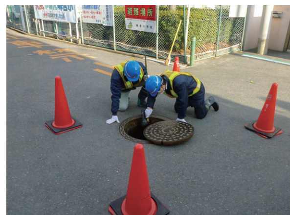
△市職員による緊急点検
